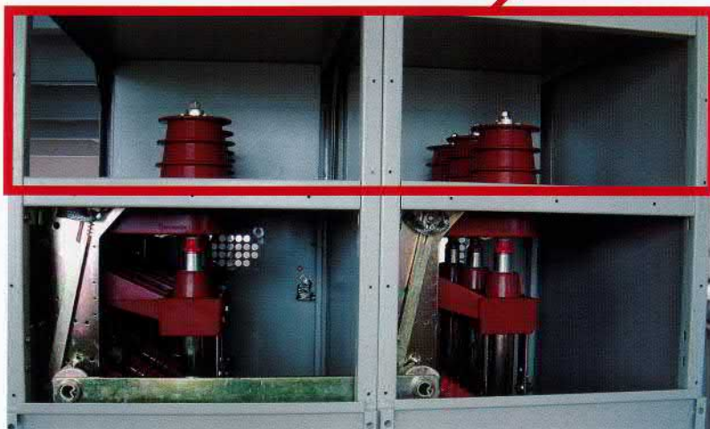
上層帶電側 (電源側)
